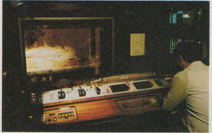
Wiener Staatsoper: Schaltpult für computergesteuerte Lichtregie
