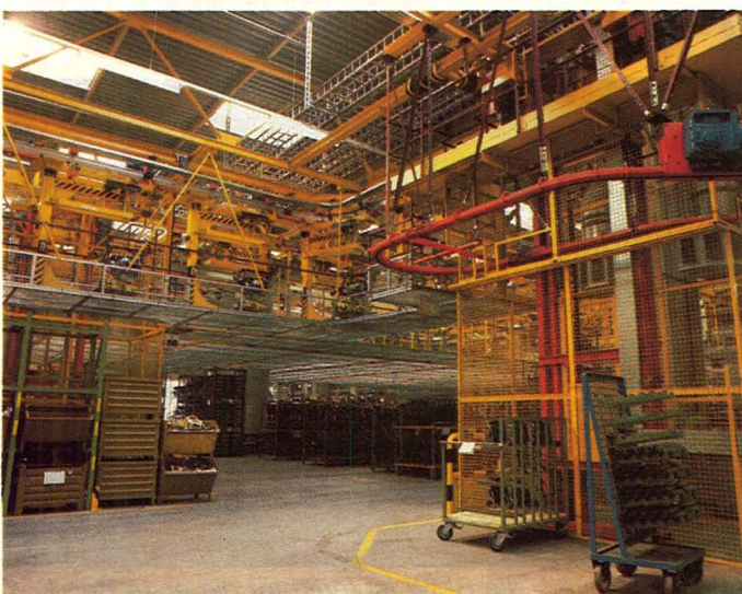
Den Verkehr auf dem 1,2 Kilometer langen Fördersystem steuert der Computer – auch im Obergeschoß
